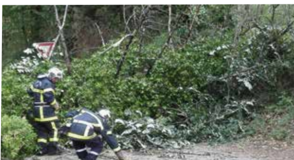
L'intervention des pompiers Rue du Loyat
